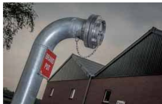
Om aan eisen van de brandweer te voldoen, liet Van Spreuwel een put slaan; voor zo'n €3.700 is er nu altijd voldoende bluswater in geval van een calamiteit.
